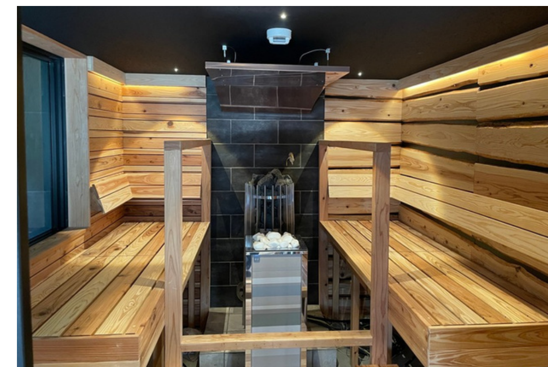
▲【日本初 部屋タイプCサウナ室】 NARVI社製サウナヒーターとHELO社製サウナ ヒーターが混在したサウナ室は日本初
