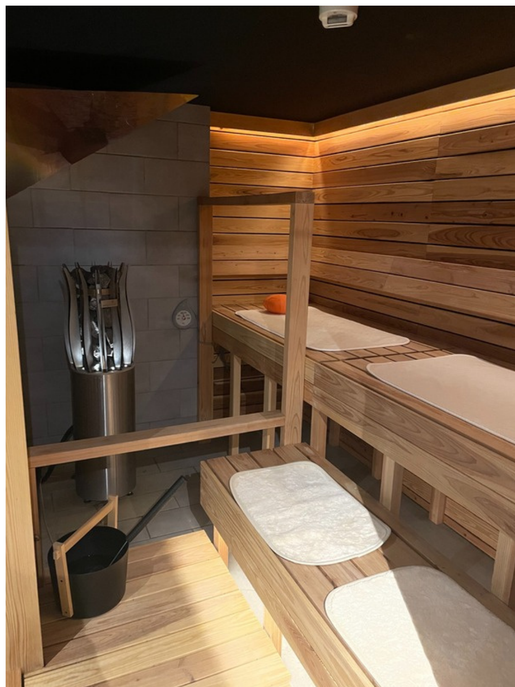
▲【日本初 「部屋タイプBサウナ室」】 MAGNUM社製サウナヒーターの導入は日本初
